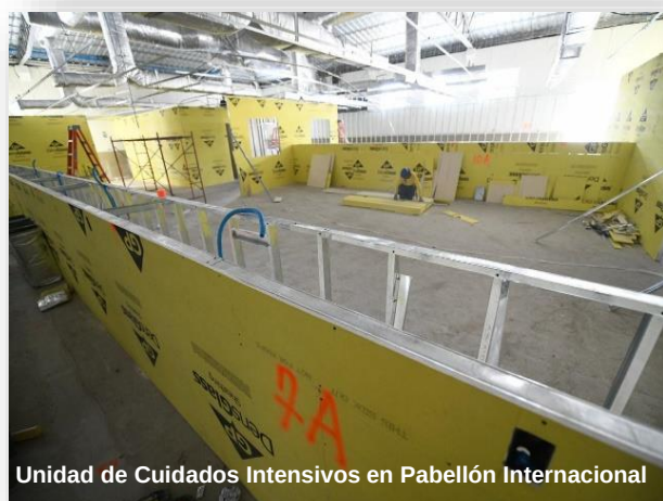
Instalaciones para Unidad de Cuidados Intensivos
